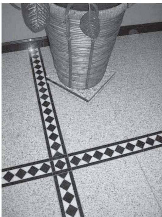
Foto 23 – Faixas decorativas executada com material de sobras. Obra Karmak. 2005 (foto do autor).
