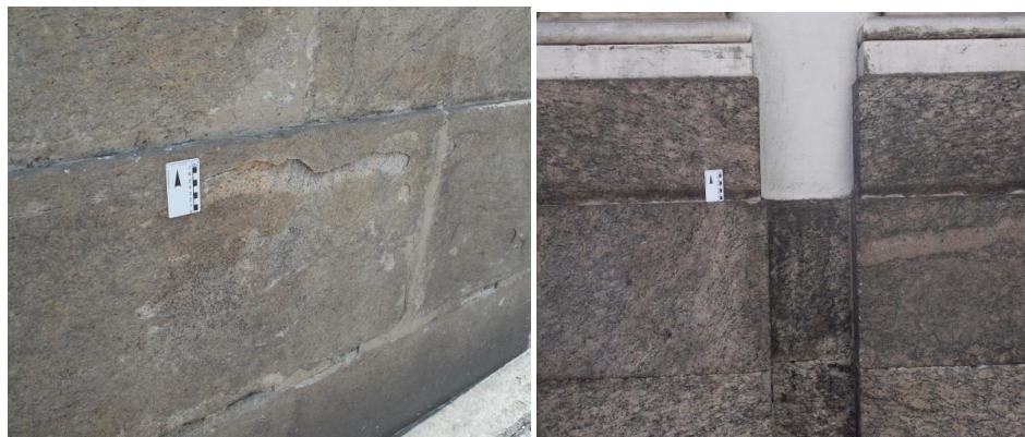
Figura 3: Deslocamento na Igreja da Candelária e mancha de umidade na Igreja Santa Cruz dos Militares.
