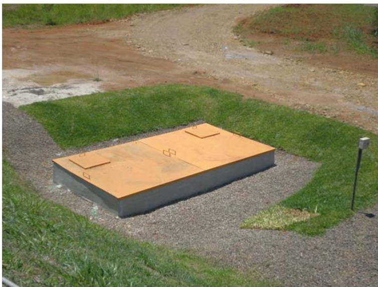
Reservatório externo para coletar drenagem externa das células
