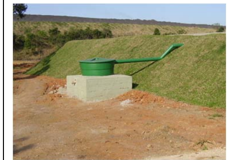
Reservatório para armazenar o escoamento superficial
