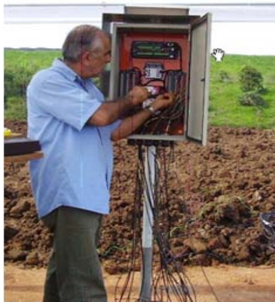
Instalação dos sensores no data logger
