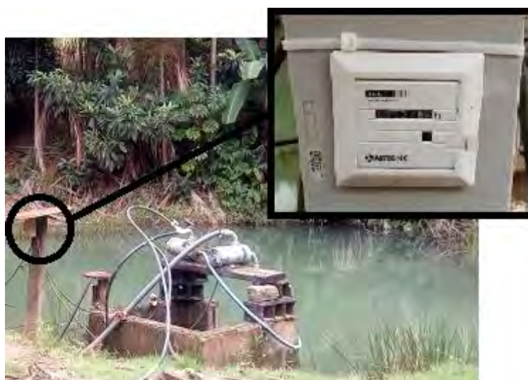
Figura 2: Horímetro instalado na bomba hidráulica.
