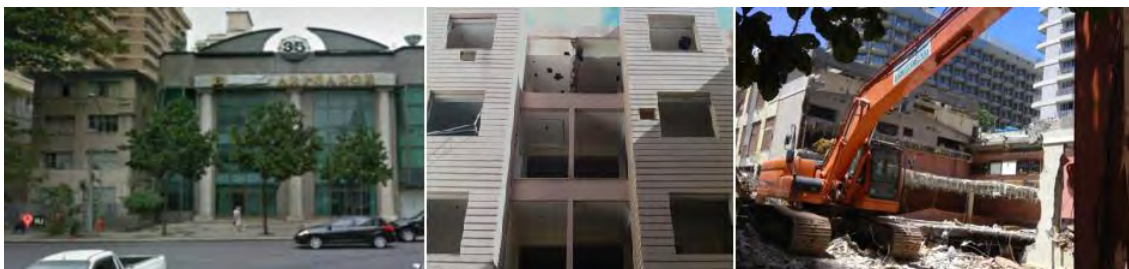
Figura 1: Fases de pós-uso: prédios originais, fase da demolição seletiva e demolição destrutiva dos prédios.
