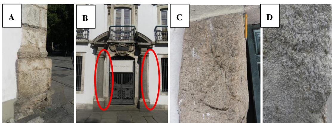
Figura 1A. Perda de massa. 1B: Crosta Negra. 1C: Eflorescência. 1D: Descamação.
