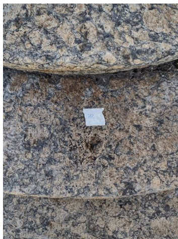
Figura 28. Cristais de feldspato quebrados e desgastados pelo impacto dos passos nos degraus.
