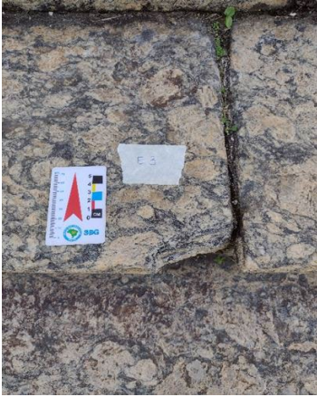
Figura 23. Quebra mecânica da quina do degrau.
