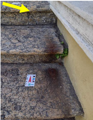
Figura 25. Fratura (seta amarela) e manchas de oxidação.
