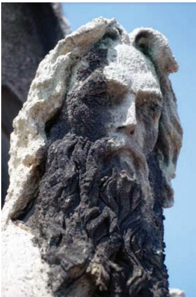
Figura 6. Obra apresentando crosta negra na Catedral de Namburg, Alemanha. Imagem retirada de: Illustrated Glossary on Stone Deterioration Patterns, ICOMOS, 2008, p.43.
