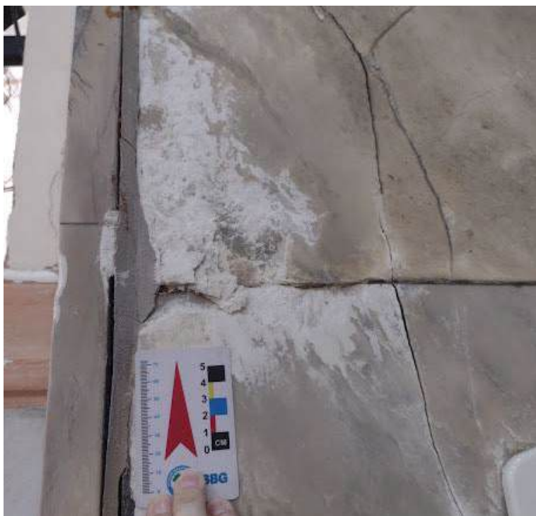
Figura 15. Mármore Cinza na parede da Paróquia do Divino Espírito Santo apresentando fraturas, alteração profunda e rejunte inadequado de argamassa.
