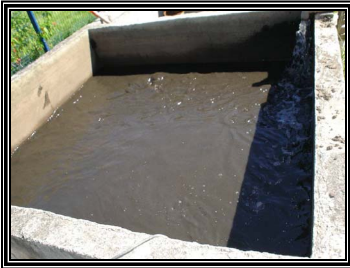
Figura 19 - Tanque de coleta do CETE
