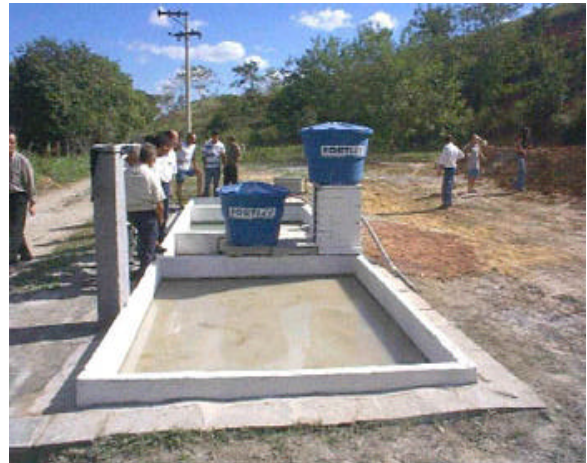
Figura 2: Estação de tratamento de efluentes em Santo Antônio de Pádua: uma experiência de sucesso.
